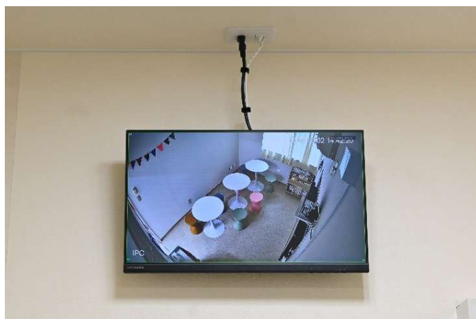
廊下に設置しているモニター
